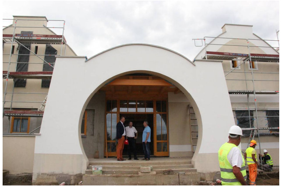
Térségünk országgyűlési képviselője, városunk vezetője és a kivitelező cég képviselője az épülő uszoda főbejáratánál
