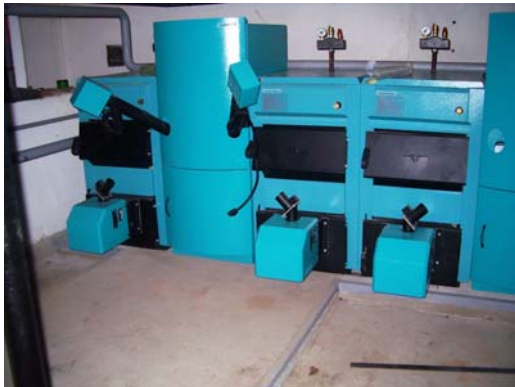
A Fáy András utcában ilyen vagy ehhez hasonló szerkezet beüzemelésével lehetne részben kiváltani a földgáztüzelést
